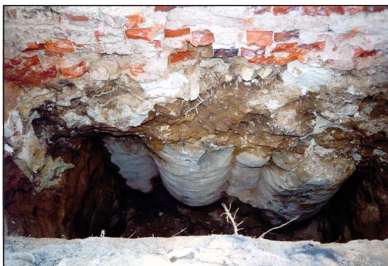
Рис. 1. Конструкции погребенных под землей фундаментов вызвали бы определенные трудности при забуривании стальных труб диаметром 325 мм.
